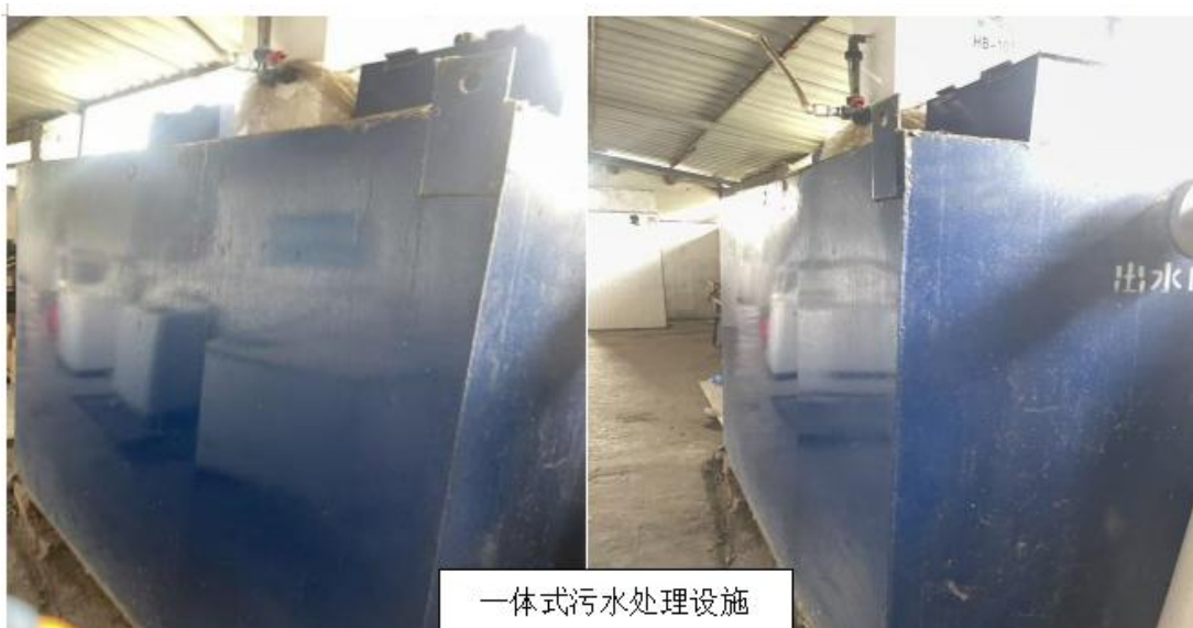
图 3-1 污水处理设施
